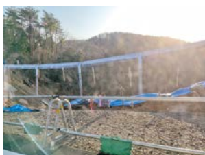
のと里山海道（片側崩落）
