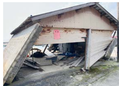
「危険」と判定された倉庫
